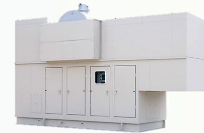
非常用ディーゼル発電機
